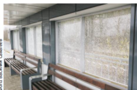
СОСТОЯНИЕ ПАВИЛЬОНА ОЖИДАНИЯ НА СТАНЦИИ МИХАЙЛОВСКАЯ ДАЧА 17 НОЯБРЯ
