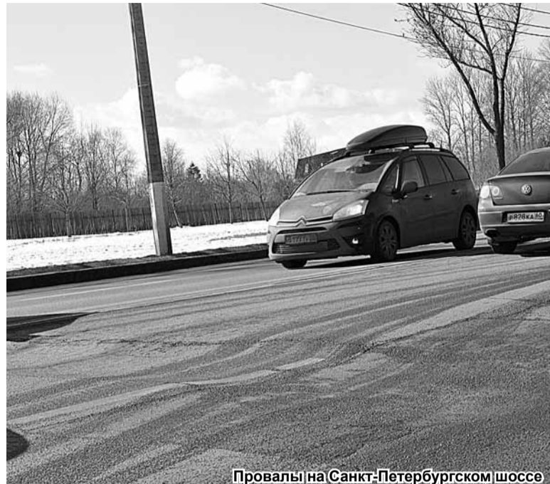
Провалы на Санкт-Петербургском шоссе
